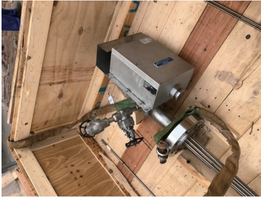
图5 某加氢装置使用的配有安全腔室的多点温度计
